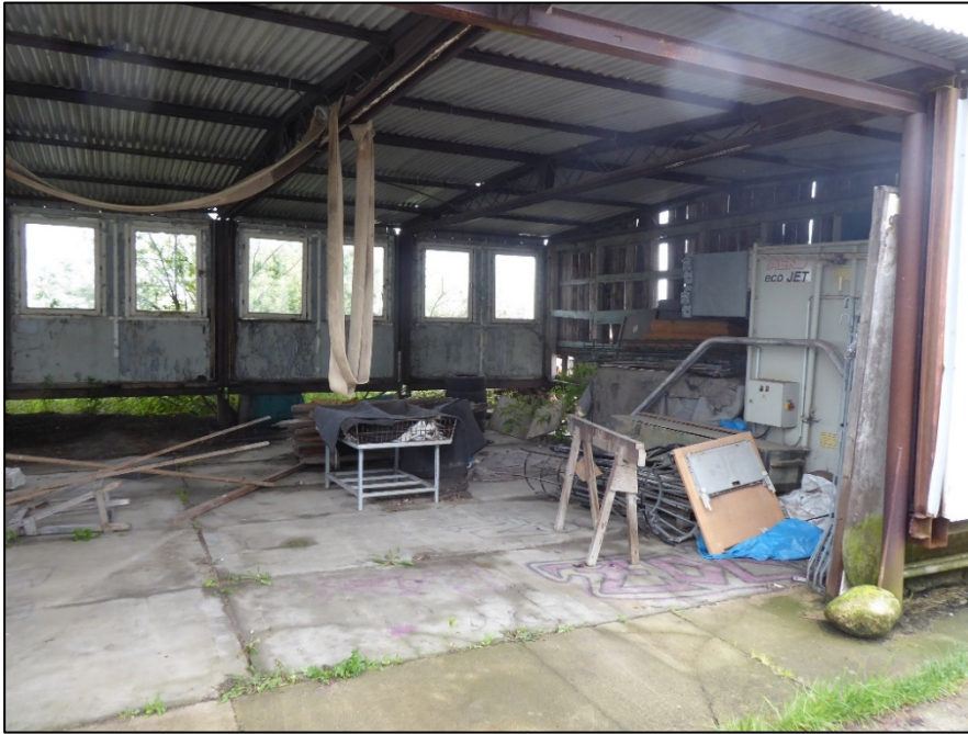
Abb. 12 Offene und zugige Halle im Plangebiet (Mai 2019) (Quelle: Büro Knoblich 2019)
